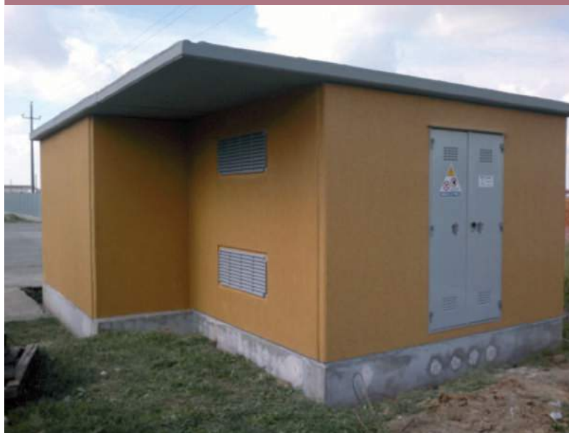
Località: Lodi (LO) Tipo di impianto: Utente passivo Potenza: 630 kVA Entrata in esercizio: settembre 2013
