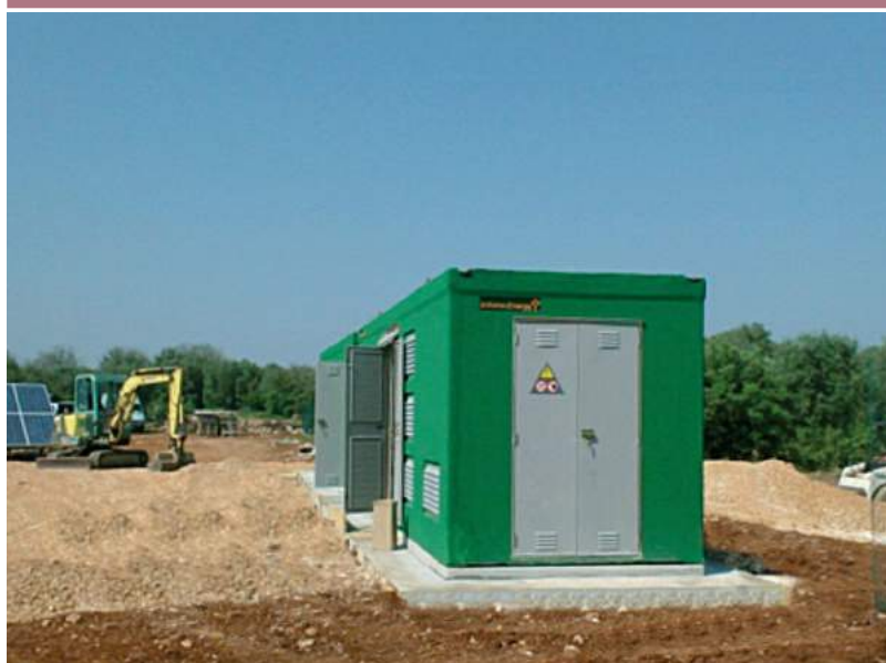
Località: Santa Cesarea (LE) Tipo di impianto: fotovoltaico Potenza: 630 kWp Entrato in esercizio: maggio 2011
