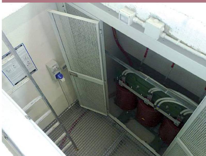
Località: Vietri sul mare (SA) Tipo di impianto: cabina interrata MT/bt Potenza: 400 kVA Entrata in esercizio: giugno 2009
