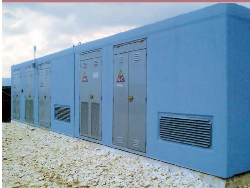
Località: Sessa Aurunca (CE) Tipo di impianto: fotovoltaico Potenza: 6,9 MWp Entrato in esercizio: aprile 2011
