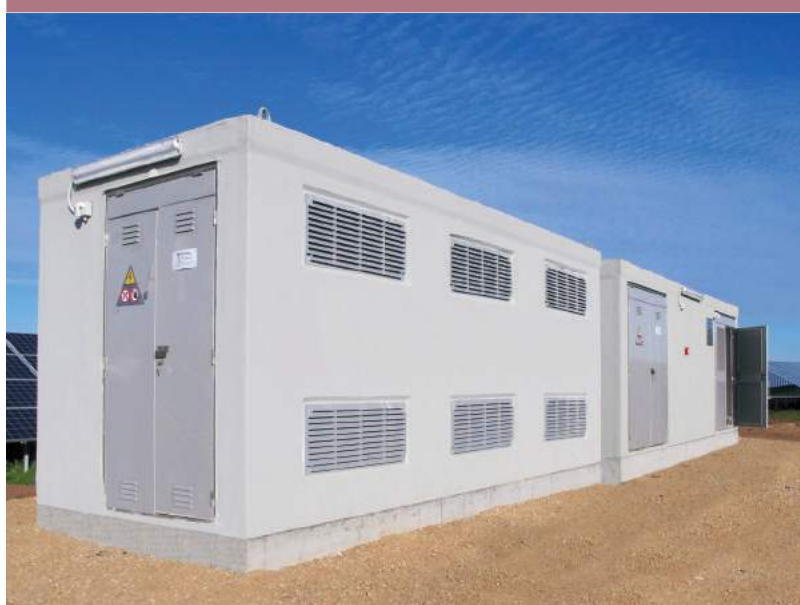
Località: Soletto (LE) Tipo di impianto: fotovoltaico Potenza: 5 MWp Entrato in esercizio: aprile 2011
