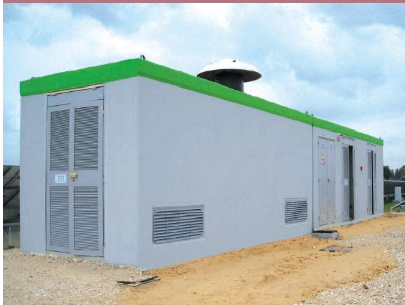
Località: Novoli (LE) Tipo di impianto: fotovoltaico Potenza: 1 MWp Entrato in esercizio: marzo 2011
